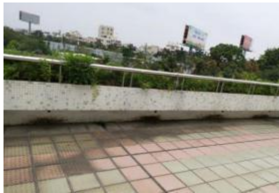
二层楼板多处渗漏，周边有发霉情况
