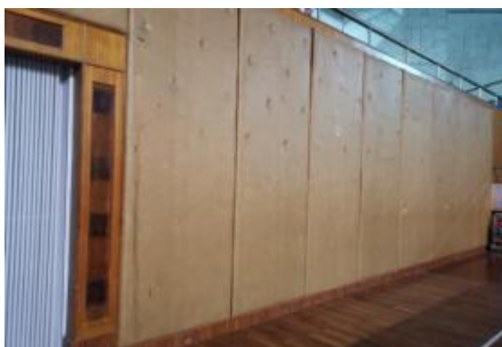
防撞棉老化、破损
