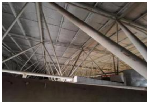
钢网架个别杆件涂层脱落、锈蚀
