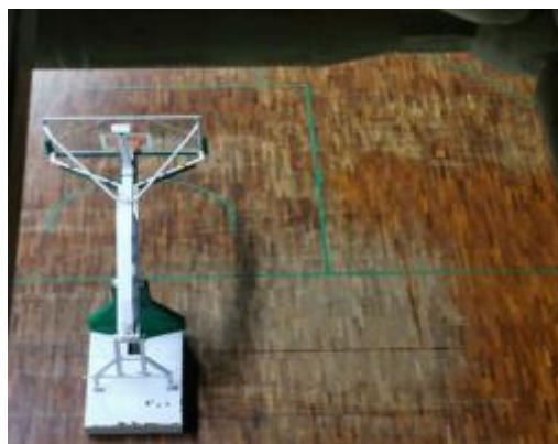
馆内木地板磨损、蛀蚀、松动、稀缝
