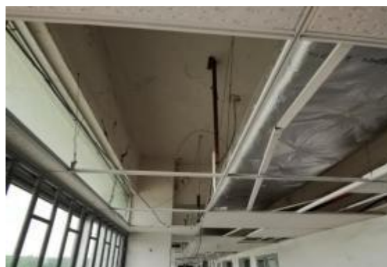
走廊吊顶破损、局部脱落
