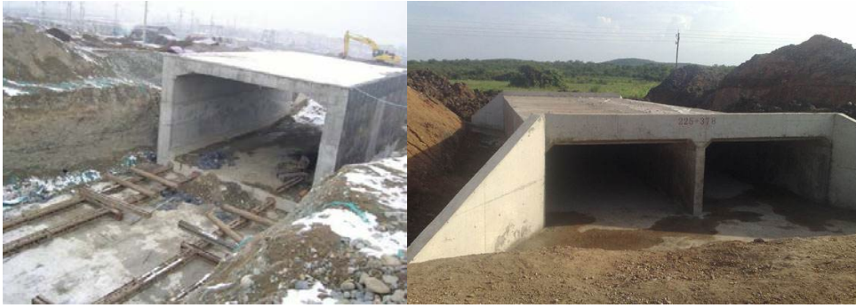
大型排水管渠
