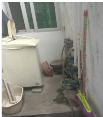
现状用户水表位于住宅内部
