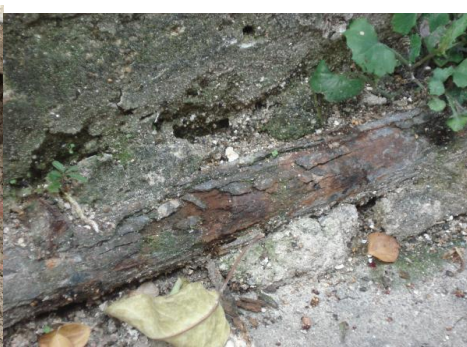
图二外壁腐蚀严重
