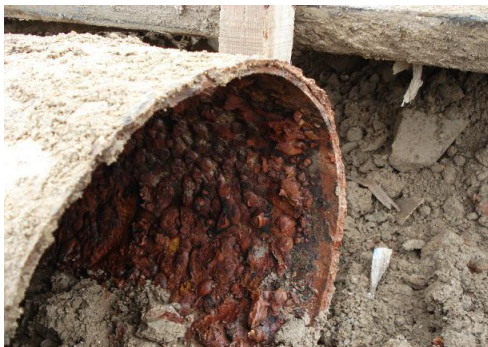
图一内壁结垢严重
