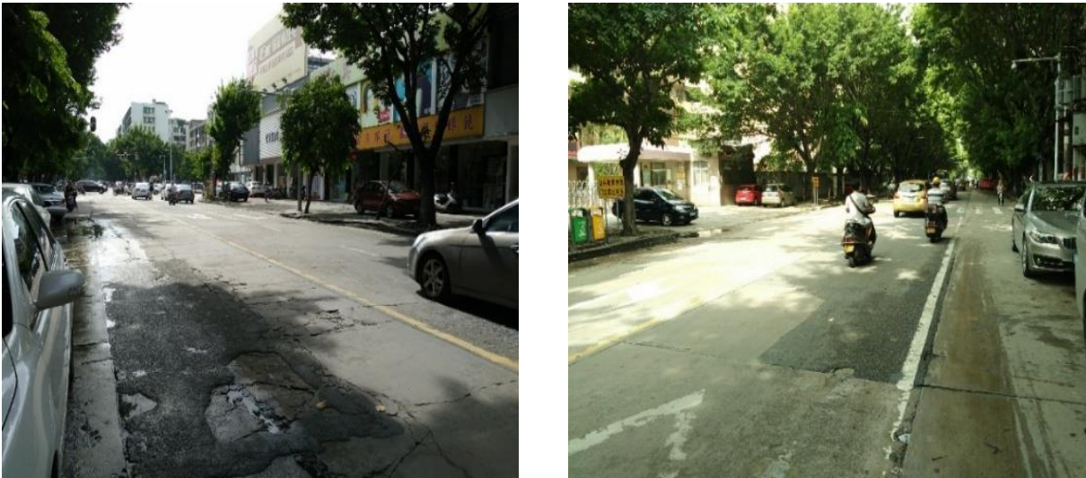
金园路面破损情况
