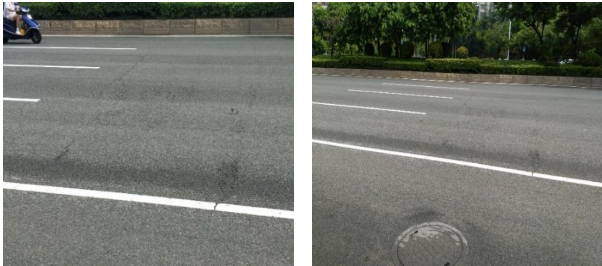
中山东路路面破损情况
