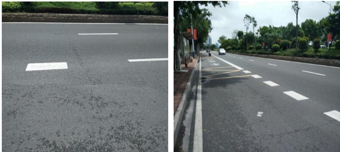
海滨路路面破损情况
