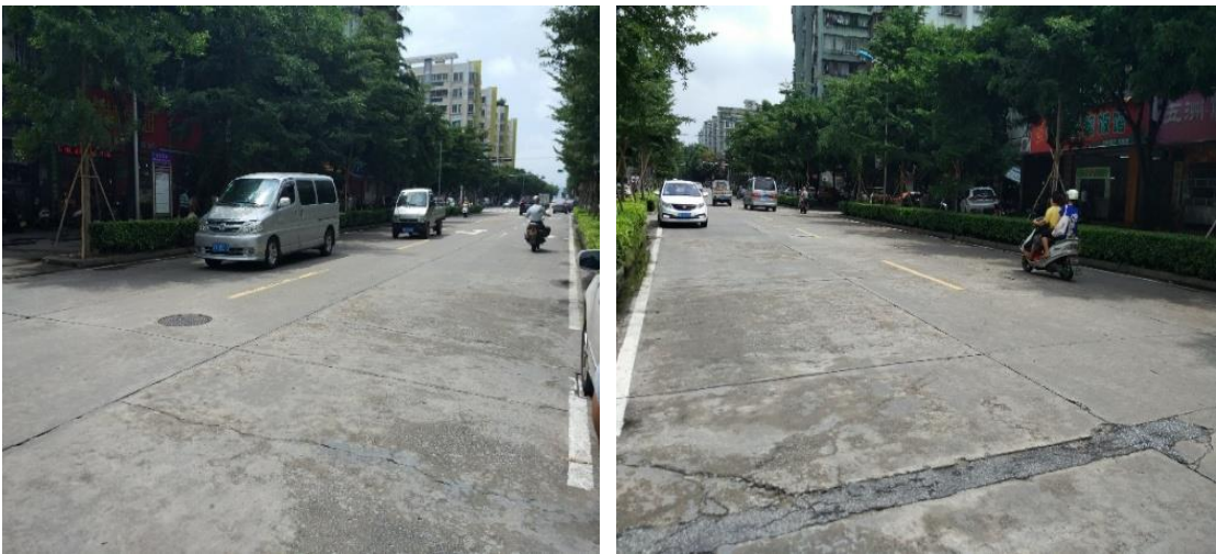
龙眼南路路面破损情况
