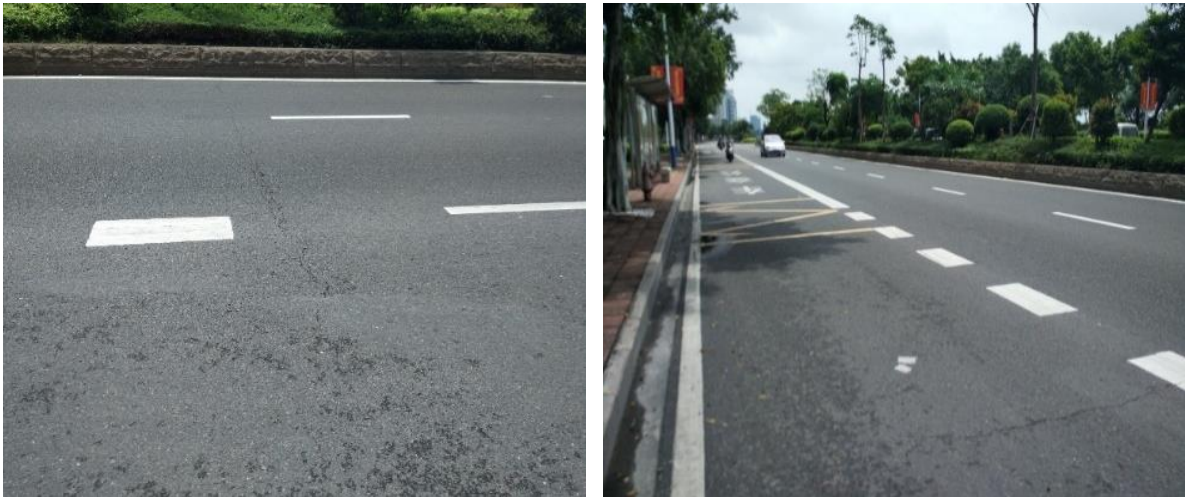
海滨路路面破损情况
