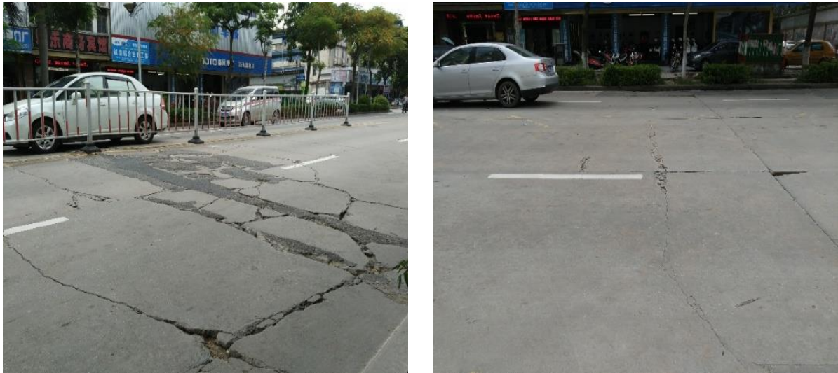
东厦路路面破损情况
