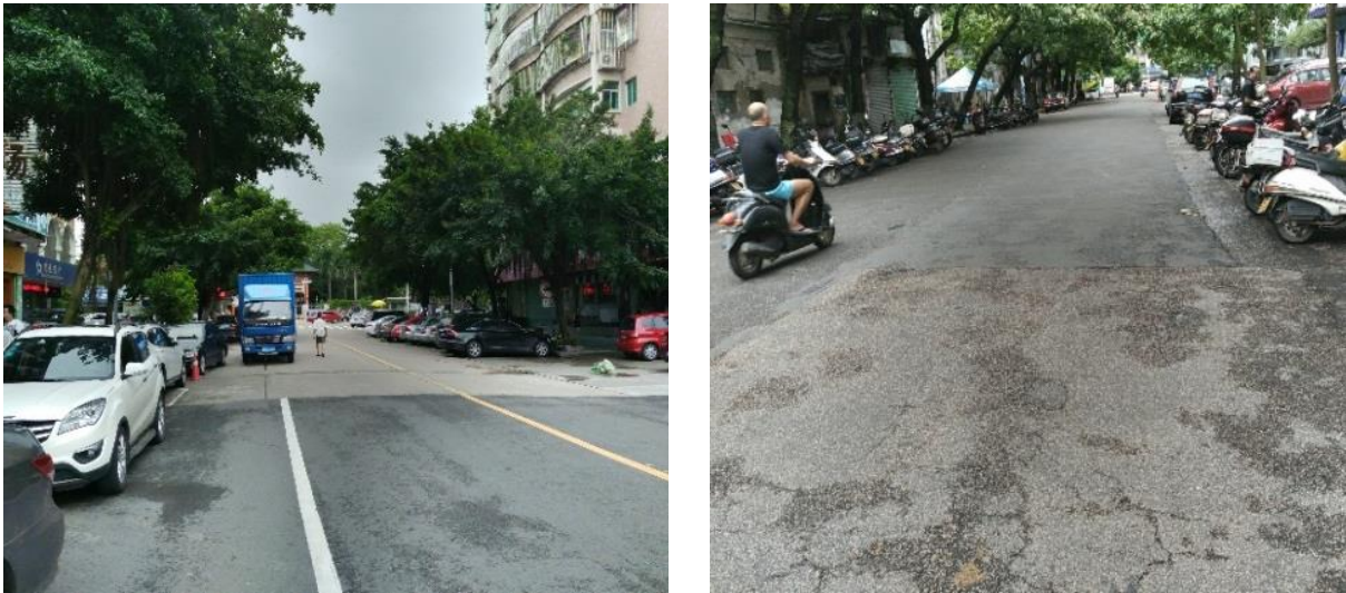
公园路路面破损情况
