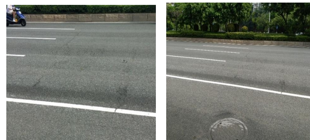
中山东路路面破损情况
