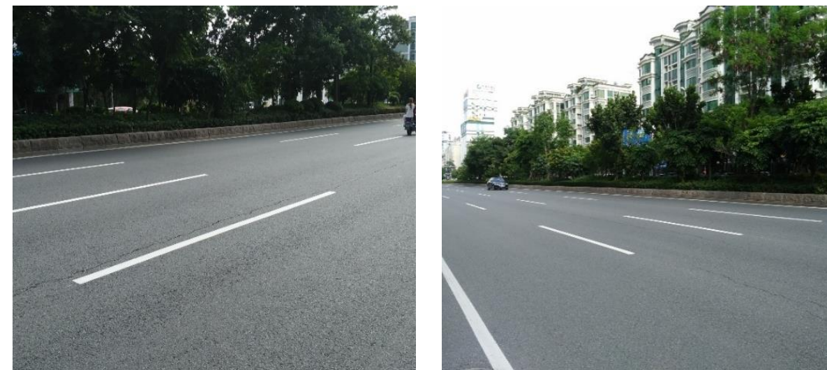
金砂东路路面破损情况
