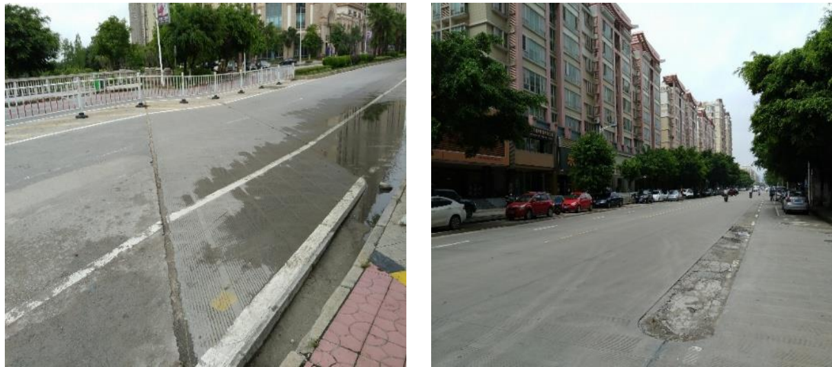
韩江路面破损情况
