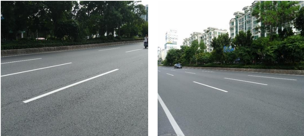
金砂东路路面破损情况
