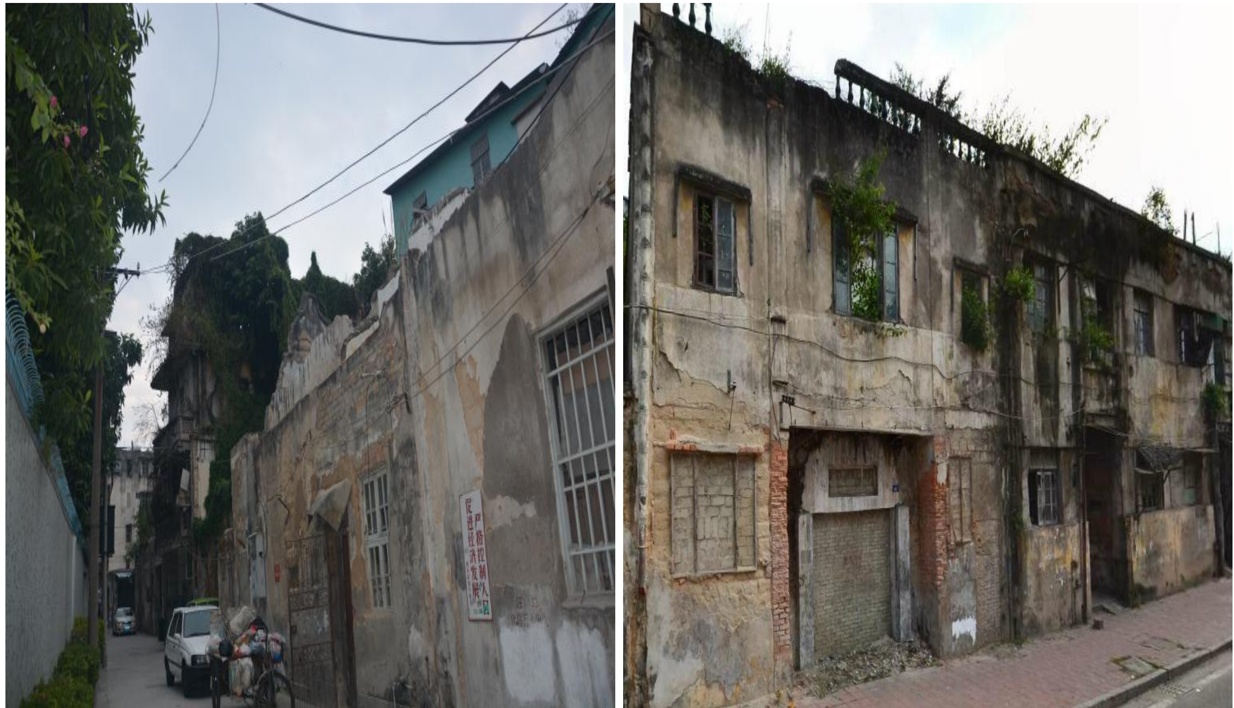
图 4-7 本项目建筑现状图（破旧建筑）
