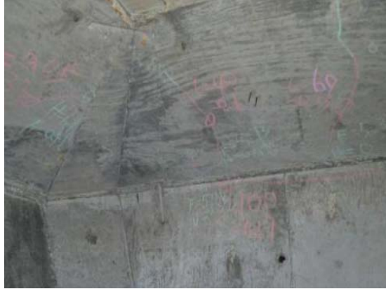
c) 倒角裂缝
