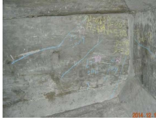
d) 腹板板裂缝
